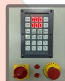
Панель управления 24V
